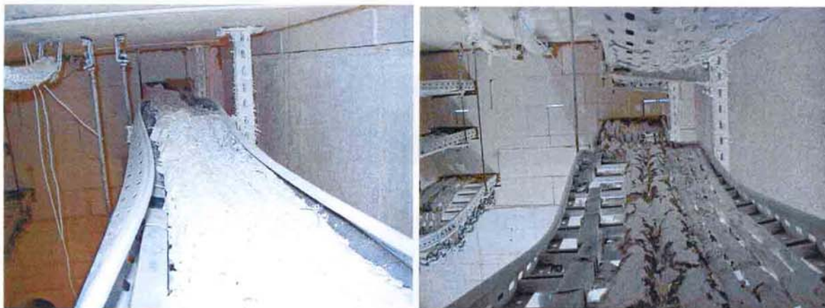
Bild A8.9 und A8.10: Blick auf die obere Kabelrinne und die mittlere Leiter nach dem Versuch
