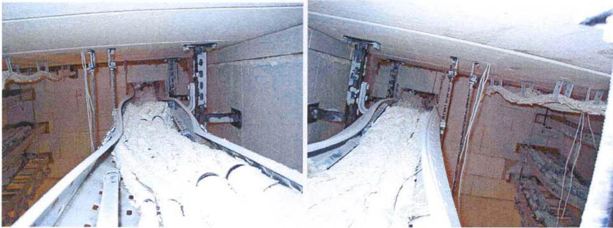
Bild A7.9 und A7.10: Blick auf die obere Kabelrinne (300 mm) nach links und rechts
