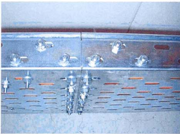
Bild A7.15: Stoßstelle Rinne außen
