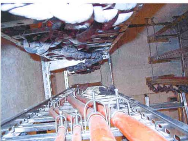
Bild A8.8: Versatz der Kabel auf der unteren Leiter
