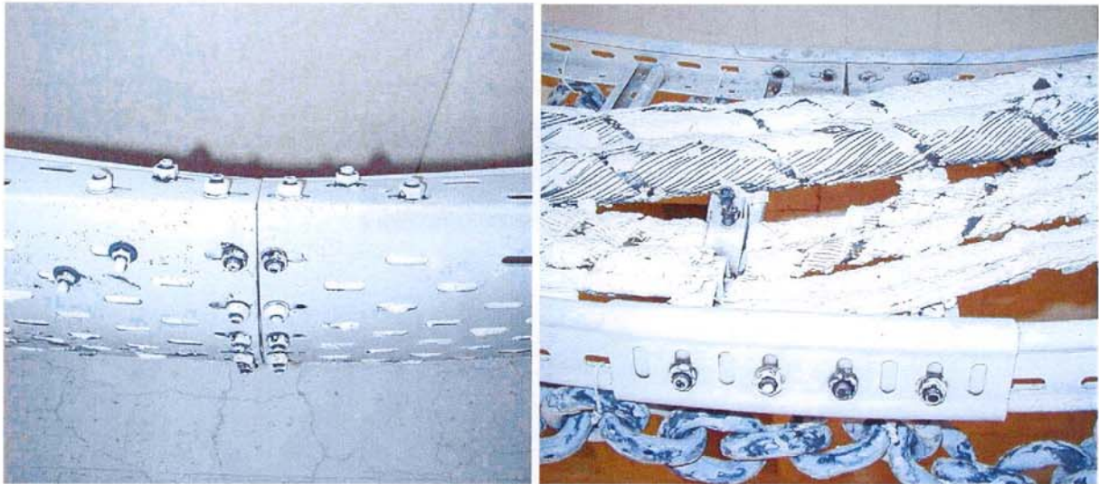
Bild A7.19 und A7.20: Stoßstellen der oberen Rinne und der Leiter nach dem Versuch
