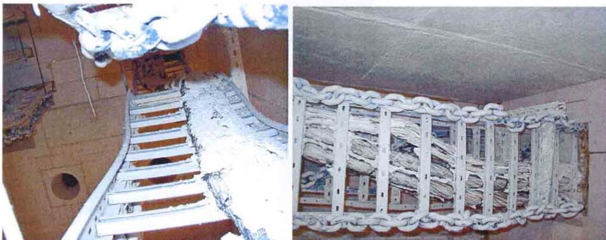
Bild A8.11 und A8.12: Blick auf die untere Leiter sowie Versatz der Kabel nach dem Versuch
