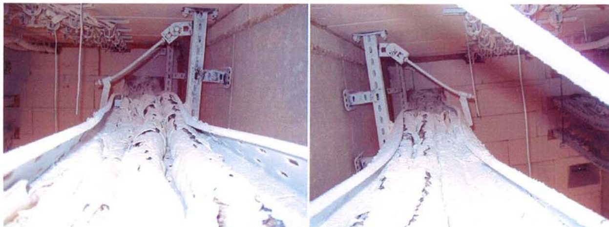
Bild A7.7 u. A7.8: Blick auf die Kabelrinne (300 mm) nach links und rechts
