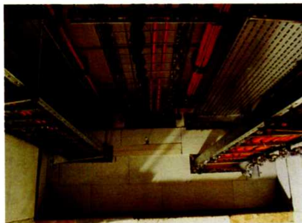
Bild A6.3 Blick in Ofen, Stirnwand links
