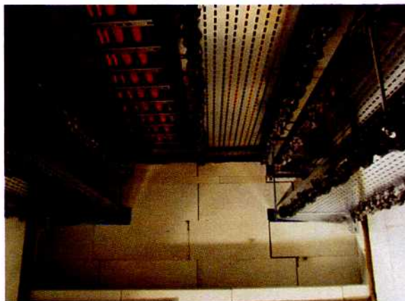
Bild A6.3 Blick in Ofen, Stirnwand links
