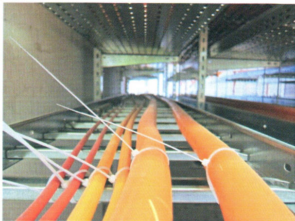
Bild A7. 5 Kabelleiter 400, links vorher
