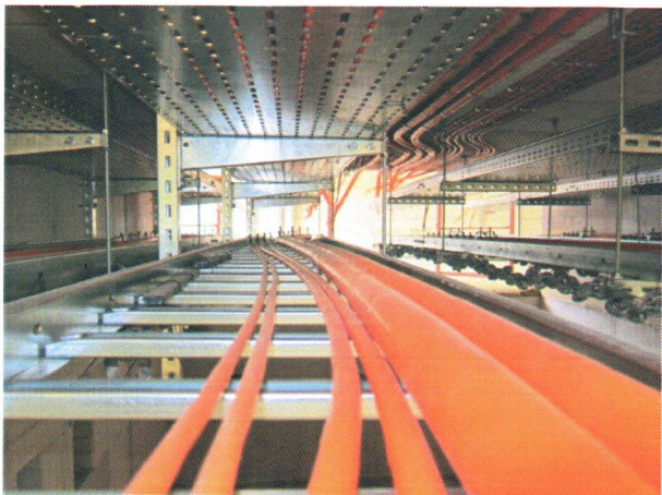
Bild A7. 7 Kabelleiter 400, rechts vorher
