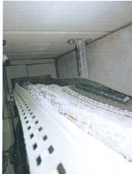
Bild A7.2 Kabelrinne 400, links nachher
