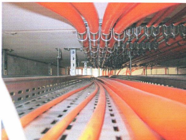
Bild A7.3 Kabelleiter 400, rechts vorher
