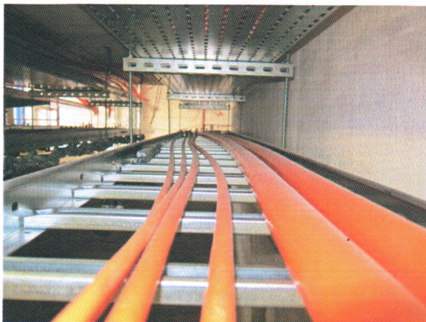
Bild A7. 15 Kabelleiter 400, rechts vorher
