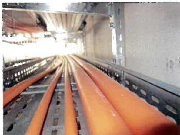
Bild A7. 7 Kabelrinne 300, System 8 vorher
