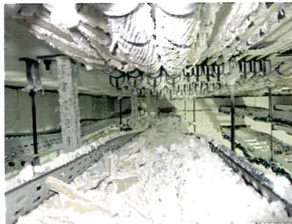
Bild A7.4 Kabelrinne 300, System 3 nachher
