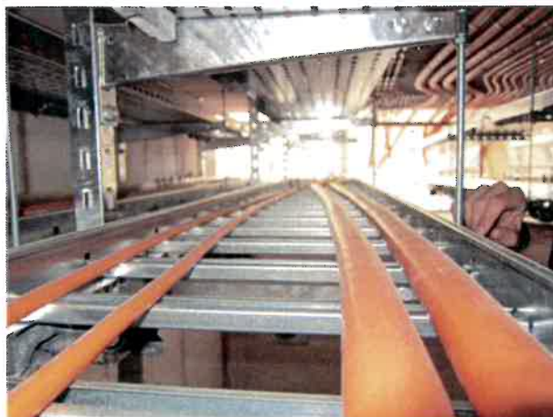
Bild A7. 11 Kabelleiter 400, System 4 vorher
