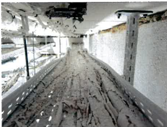
Bild A7. 6 Kabelrinne 300, System 7 nachher
