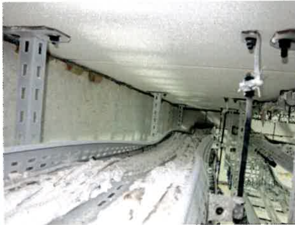
Bild A7.2 Kabelrinne 300, System 1 nachher
