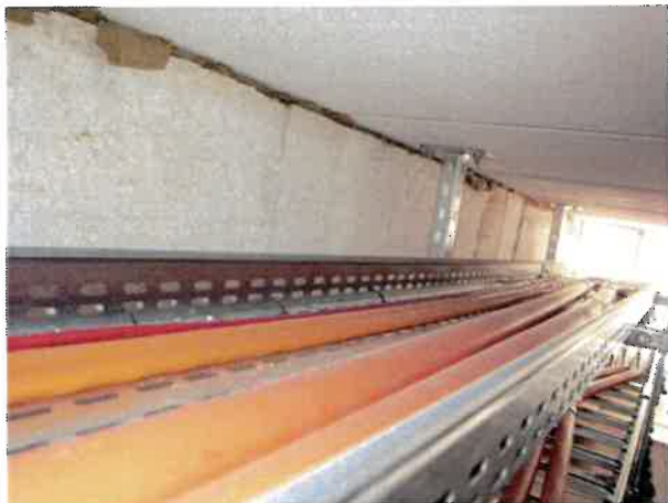
Bild A7.1 Kabelrinne 300, System 1 vorher
