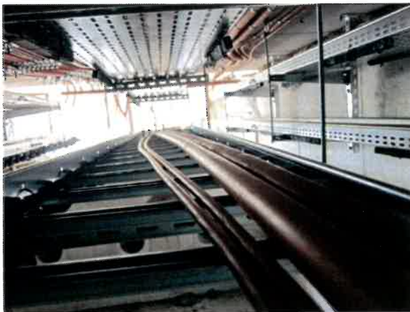
Bild A7. 15 Kabelleiter 400, System 6 vorher
