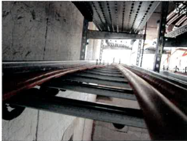
Bild A7. 9 Kabelleiter 400, System 2 vorher
