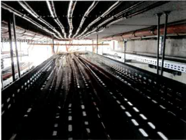
Bild A7. 13 Kabelrinne 400, System 5 vorher
