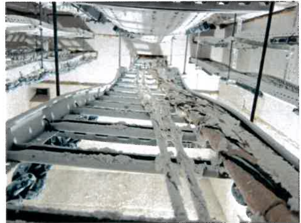
Bild A7. 16 Kabelleiter 400, System 6 nachher
