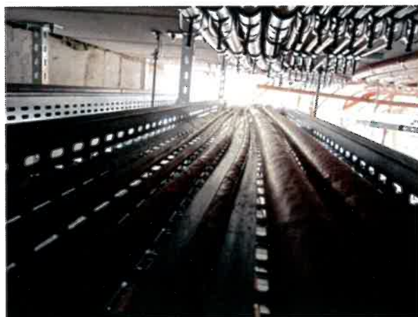
Bild A7.3 Kabelrinne 300, System 3 vorher
