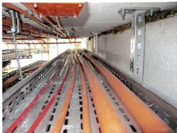
Bild A7. 5 Kabelrinne 300, System 7 vorher
