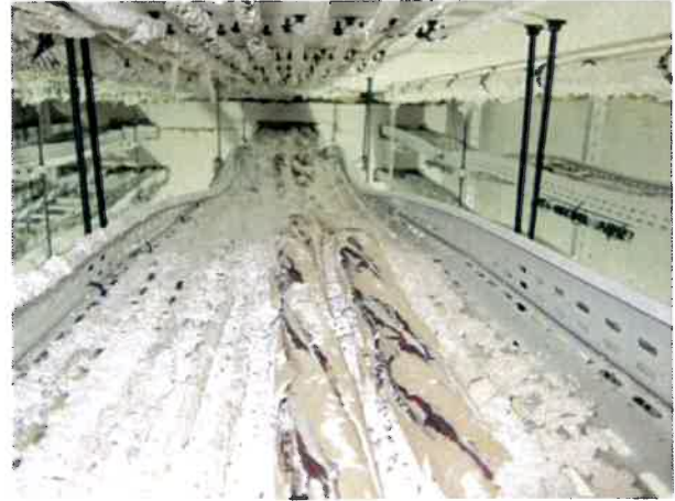
Bild A7. 14 Kabelrinne 400, System 5 nachher
