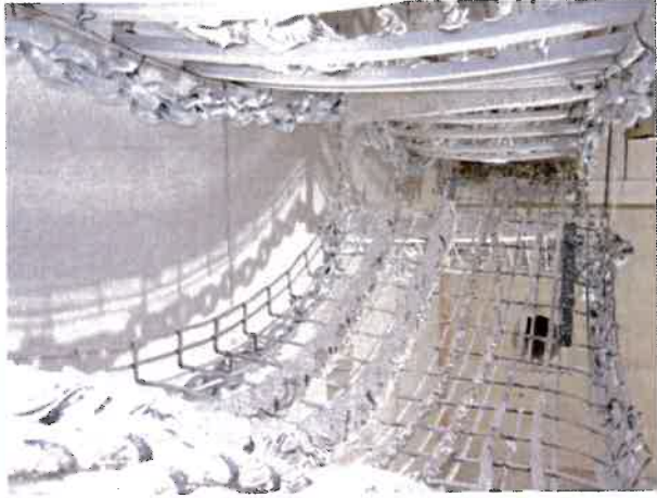
Bild A7.10 Kabelgitter 600, links nachher
