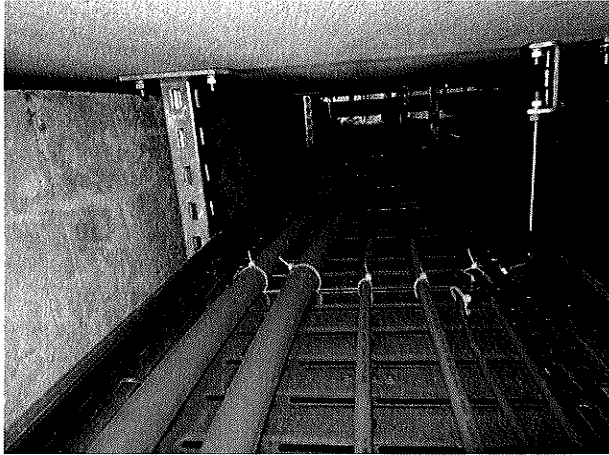
Bild A7. 1 Kabelrinne 400, links vorher
