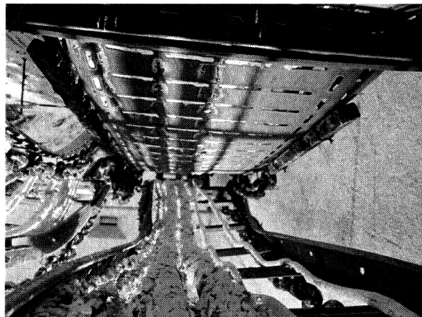
Bild A7. 12 Kabelleiter 400, rechts nachher (System 5)
