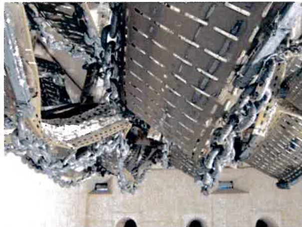
Bild A7. 32 Brandraum, rechte Wand nachher
