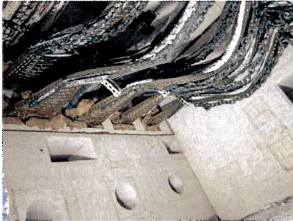
Bild A7. 29 Brandraum, linke Wand nachher
