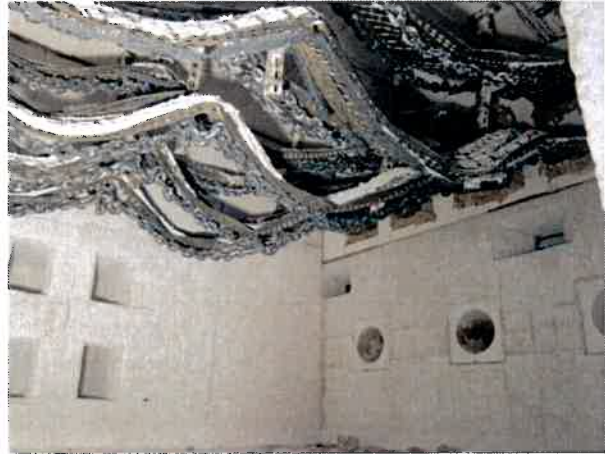
Bild A7. 30 Brandraum, rechte Wand nachher
