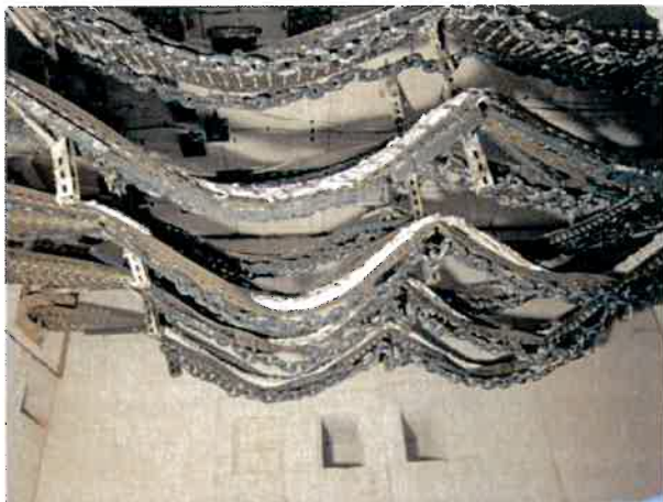
Bild A7. 33 Brandraum, mittig, nachher
